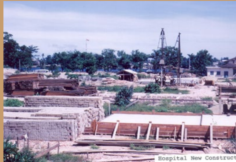
Xây dựng mới Bệnh viện Trung ương Huế. Khu 4 tầng (1969 - 1972) New construction of Hue Central Hospital 4 - storey area (1969 - 1972)
